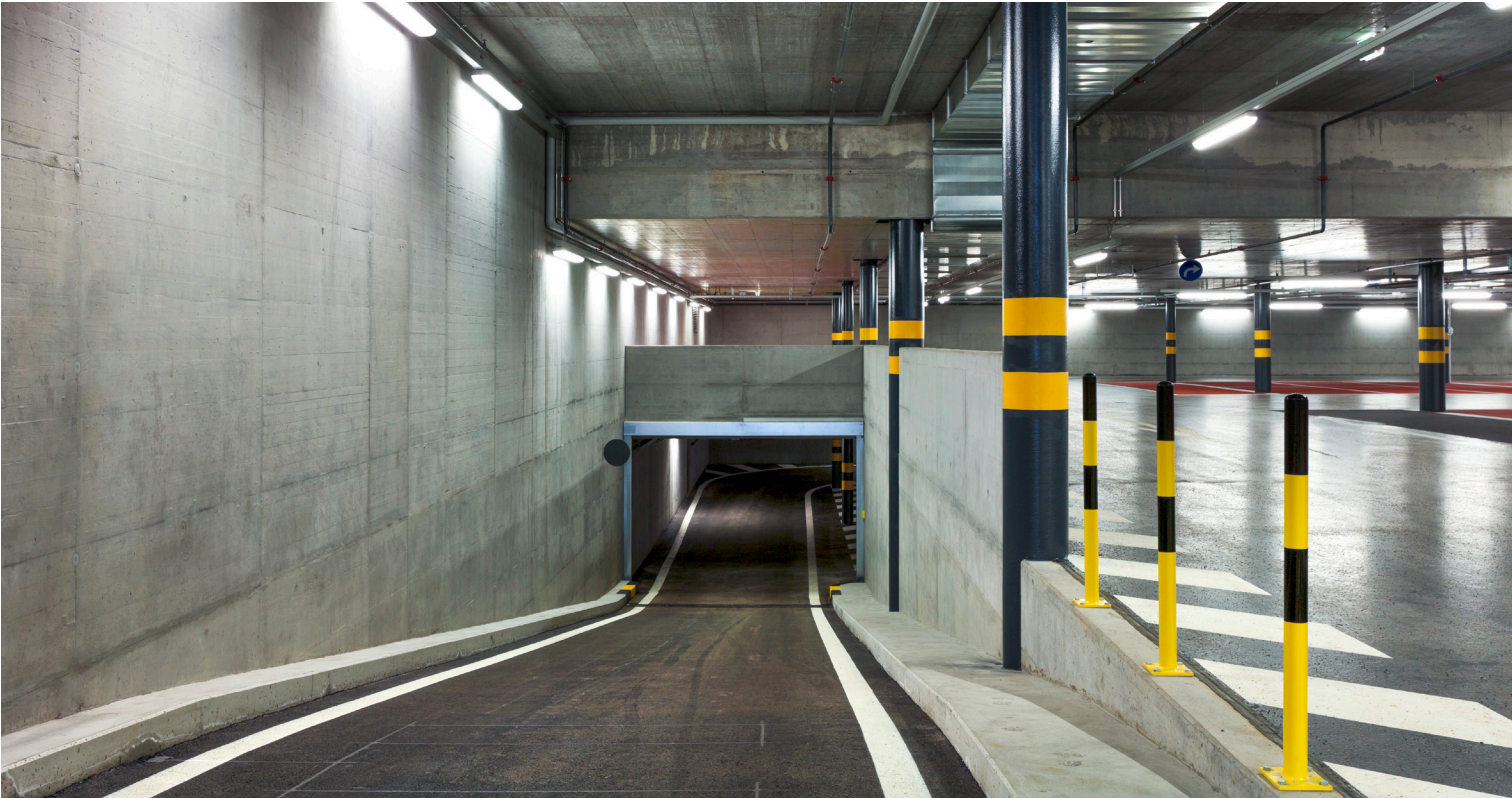
Tiefgarage Wien, Leuchte: POLEDO SLIM 42W
