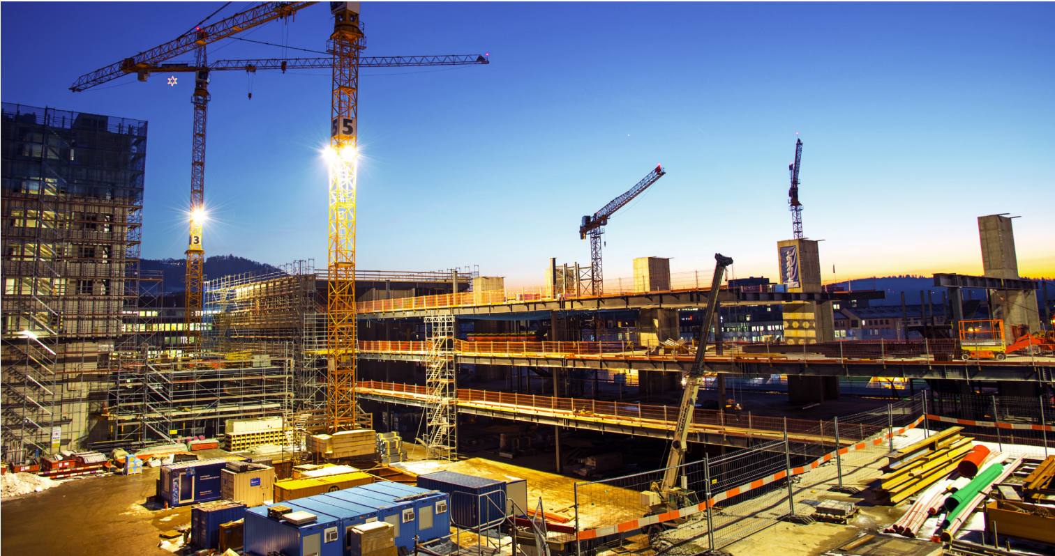
Neubau Wien, Leuchte: ATUR 300
